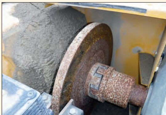
Corrosion sur l'accouplement.
